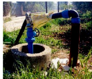
SERVIZIO A PAGINA 6 >> ARIF Un impianto idrico
