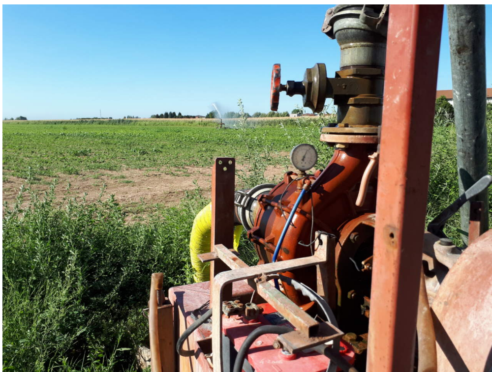
L'impianto di irrigazione soia
